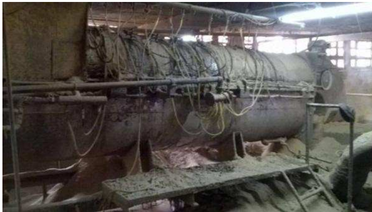
Fig. 1.5. Encolado de las partículas: Encoladora marca Draiss.
