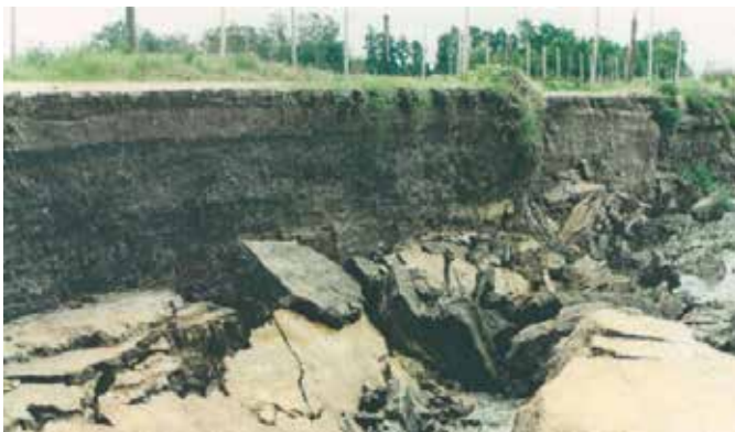
Imagen 3. Club de Casa y Pesca de Helvecia. Detalle de proceso erosivo. Gentileza del Senador Pignata
