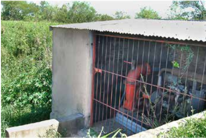
Imagen 13. Estación de bombeo, zona Colonia Mascías
