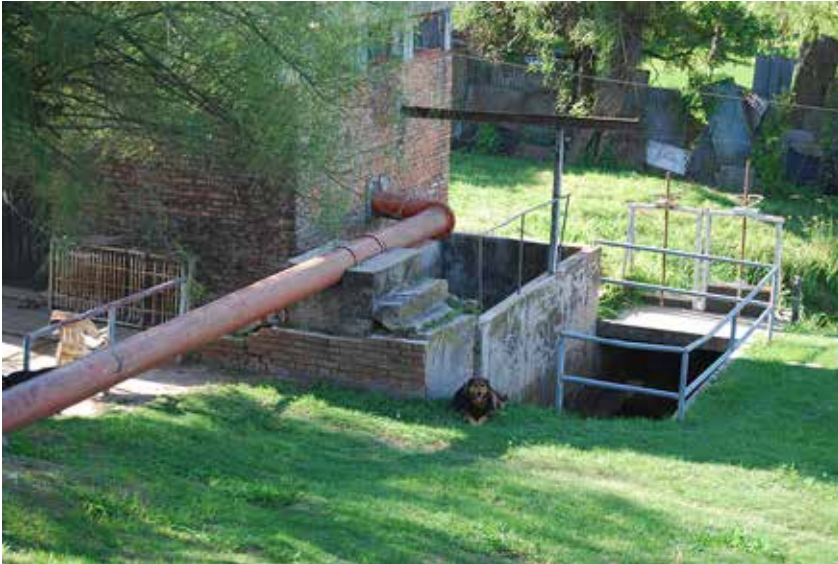
Imagen 15. Estación de bombeo barrio «Los espinillos» San José del Rincón
