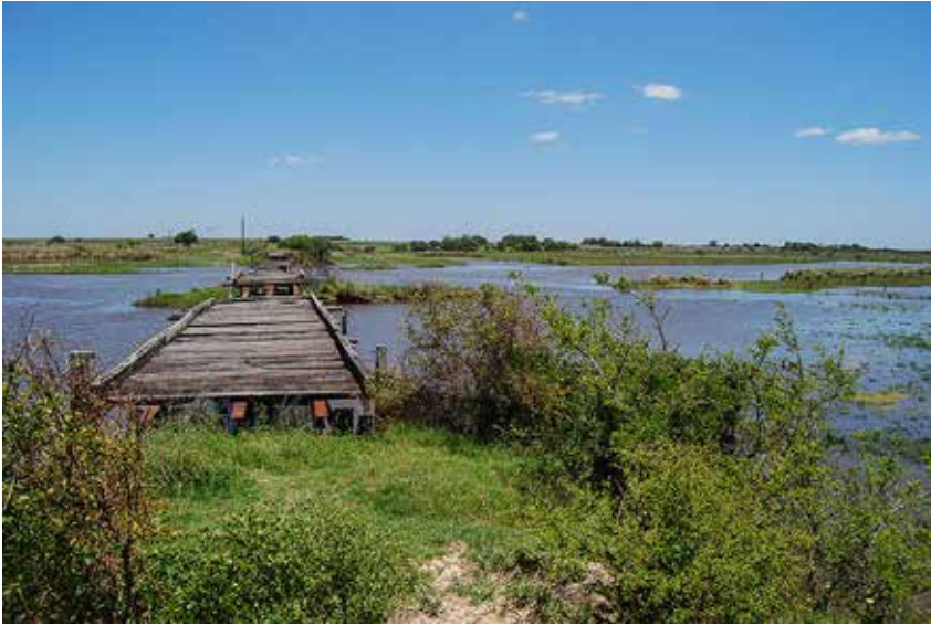
Imagen 16. Puente derruido sobre el Arroyo Saladillo Dulce
