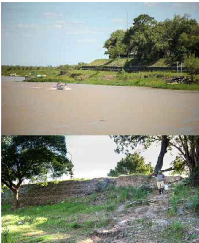
Imagen 12. Defensa contra inundaciones y terraplén colchoneta de alambre galvanizado, zona Saladero M. Cabal
