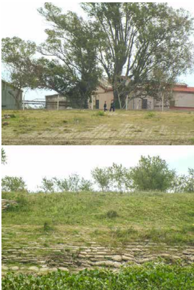
Imagen 7. Terraplén Garello con bloque de hormigón y terraplén Garello con bolsas rellenas con suelo o mezclas de suelo rellenas con cal o cemento
