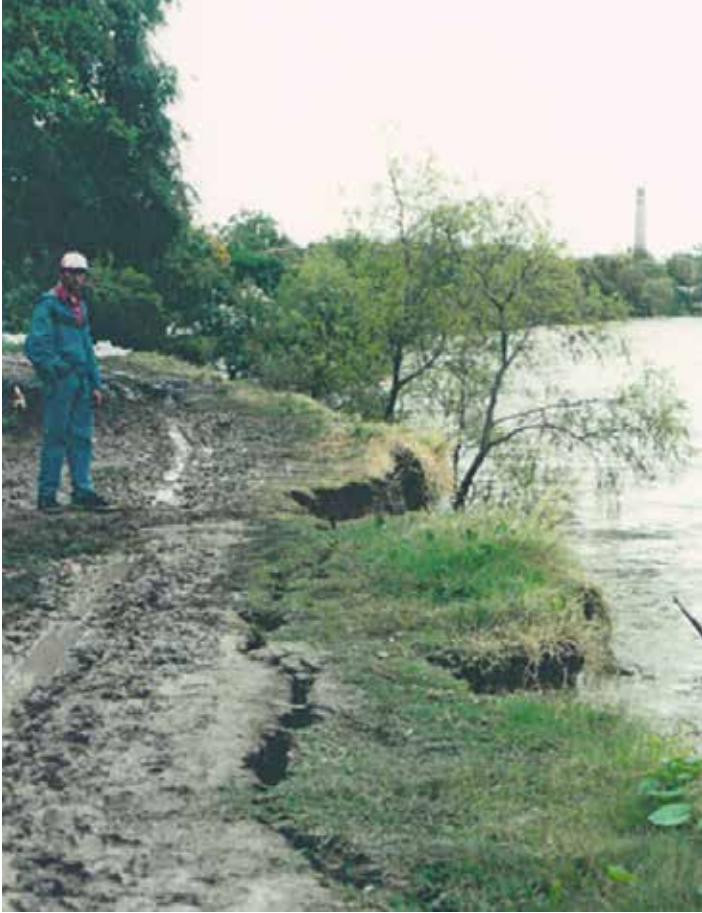
Imagen 4. Defensa Saladero Cabal tramo crítico por línea de corte en la estructura de la defensa socavada
