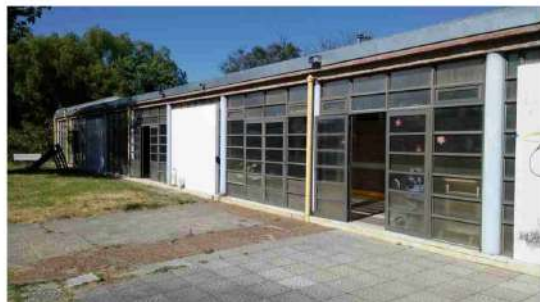
Diferencias de nivel interior / exterior . Pisos desprendidos
