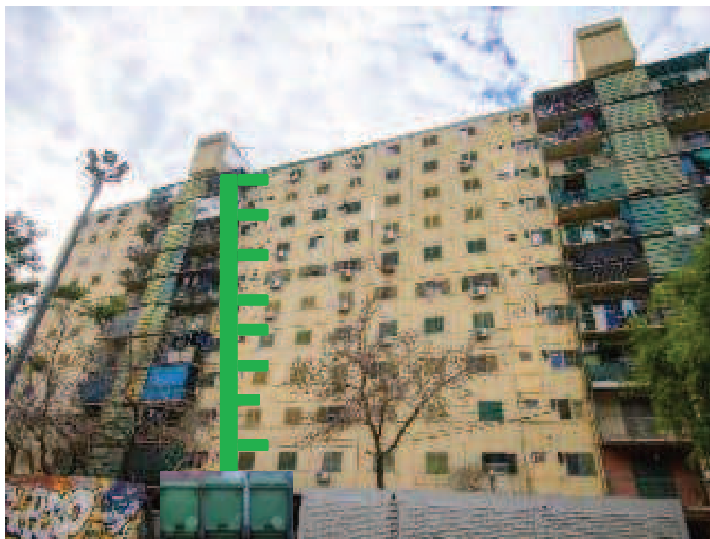
Figura 8.22: Vista de sistema de ductos para torres. Fuente Elaboración propia del autor, 2024
