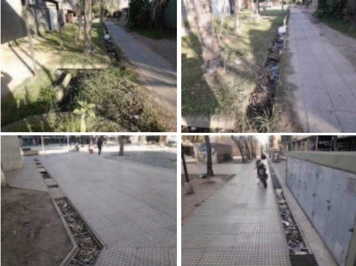
Figura 6.5: Vista de acumulación de residuos varios y malezas. Fuente Registros propios, 2024
