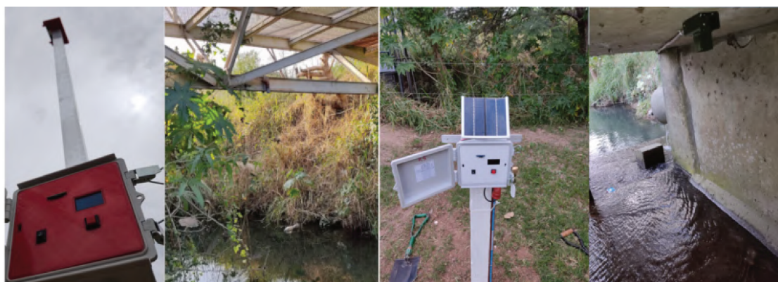
Figura 1.10: Equipos instalados en una cuenca urbana de la ciudad de Santa Fe.
