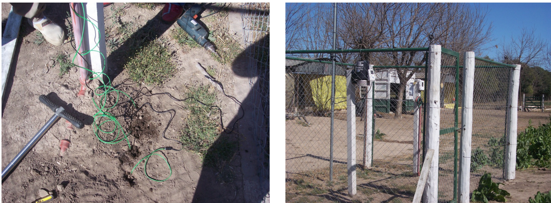
Figura 4.5: Instalación de sensores Watermark y datalogger en Ataliva.
