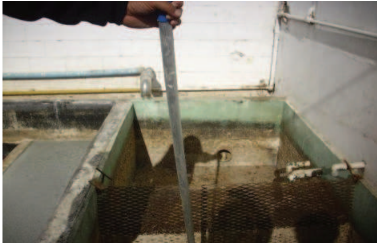
Figura A-1.9: cámara separadora de sólidos gruesos. Fuente: propia, 2018.
