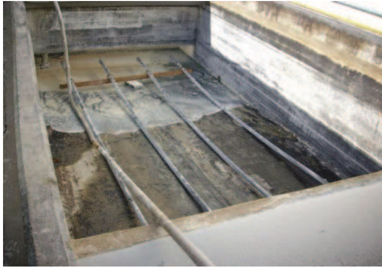
Figura A-1.10: pileta de separación de grasas. Fuente: propia, 2018.
