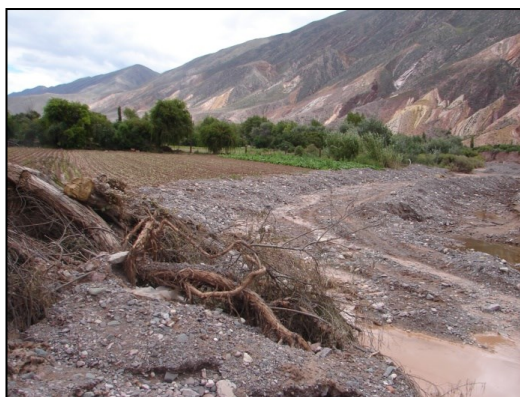
Instalación de defensivos de emergencia (troncos y ramas atadas). Vista de los dos primeros anillos de material suelto de protección (flechas). El 4to. anillo externo fue construido con una longitud de 538 m.
