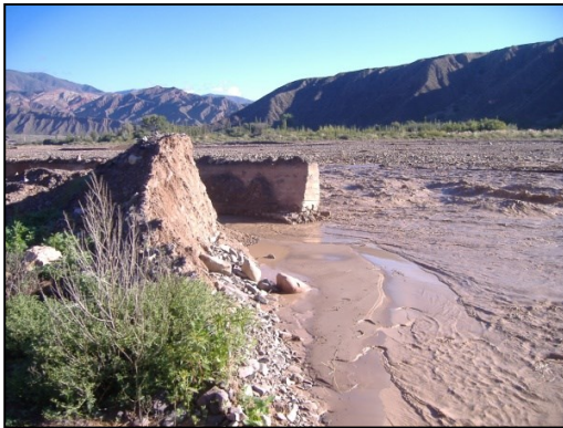
Defensas de hormigón armado y bordo de áridos en cercanías de Toma 2, tomada durante crecida de marzo de 2011.
