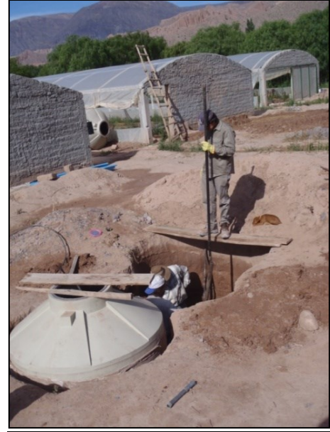
Figura 2.17: Pozos excavados en el pueblo de Maimará. Izq.: Aljibe tradicional en vivienda antigua; Der.: Excavación para aprovechamiento de la freática en la Cooperativa de Floricultores. Fotos: J. P. Zamora G.
