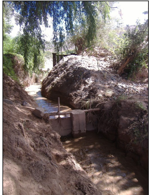
Compuertas generales en toma del Canal 2. Fecha: 10-febrero-2012.
