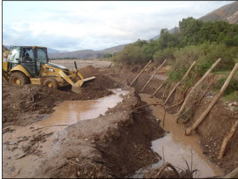
Figura 9.7: Construcción de defensivos de emergencia. Excavado de zanjas para el armado de defensas en base a troncos, ramas y alambre, durante la crecida de febrero de 2013. Foto: J. P. Zamora G.
