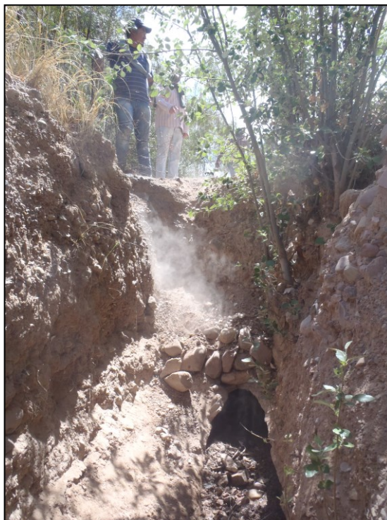
Figura 5.14: Obturación parcial del tubo de concreto del canal CS1B. Este tubo atraviesa una quebrada transversal. Foto: J. P. Zamora G.
