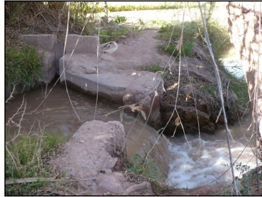
Compuerta de metal (para derivación a parcela de riego) con guía de mampostería.
