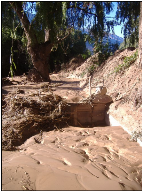
Estado de las compuertas después de una crecida del río. Marzo de 2011.
