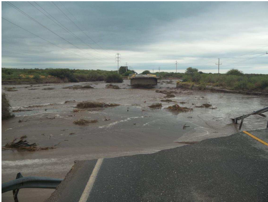
Figura 1. 42: Rompimiento de los terraplenes de acceso - puente RN
