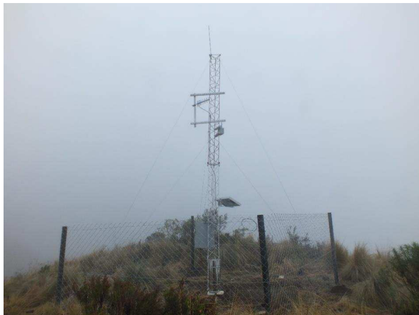
Figura 1. 13: Sensor de nivel colocado sobre el Río Ambato que conforma para el Sistema de Alerta Temprana para la localidad de El Rodeo
