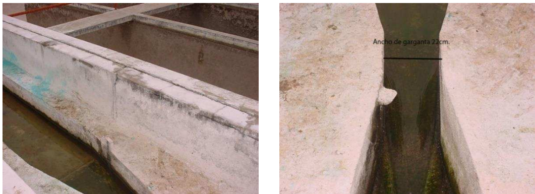
Figura 1. 19: Canaleta Parshall utilizada para determinar el caudal derivado del Dique Motegasta (dpto., La Paz) a su la planta potabilizadora.
