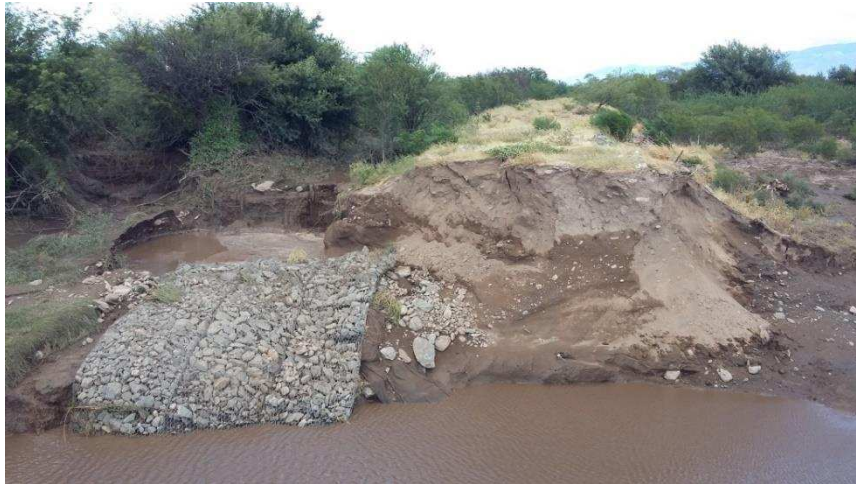
Figura 1. 43: Ruptura por socavación del terraplén de desvío del cauce del río Paclín
