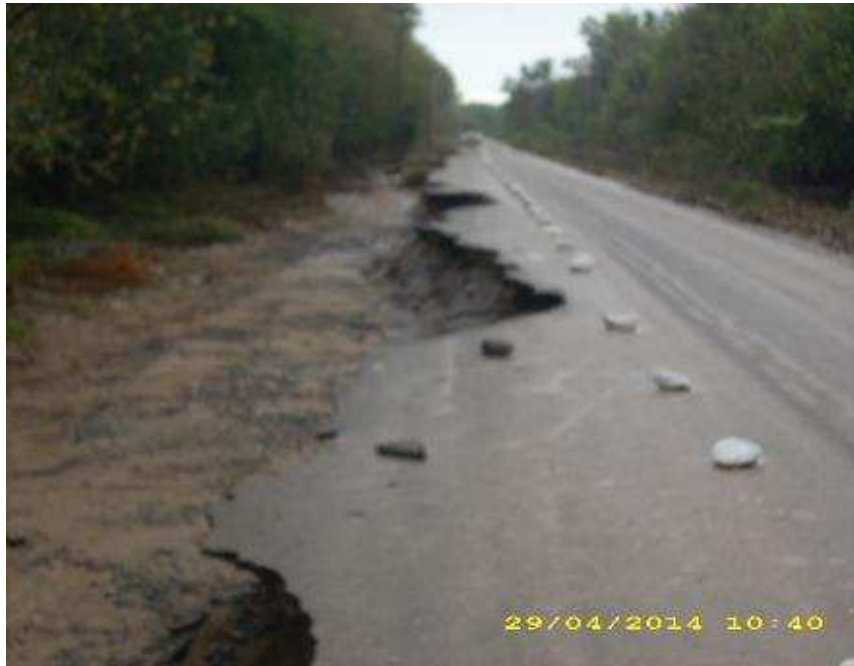
Figura 1. 35: Afectación del cruce por el vado Los Pensamientos –Río El Abra. Abril 2014
