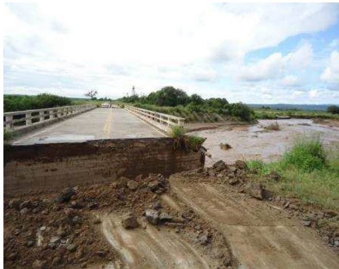
Figura 1. 38: Corte terraplén de aproximación margen izquierda río El Abra RN N° 64 Marzo 2015.
