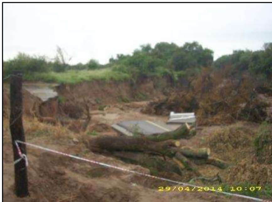
Figura 1. 34: Rotura de la capa asfáltica producto del carcavamiento debido a la erosión retrocedente del Río El Abra (Abril 2014)
