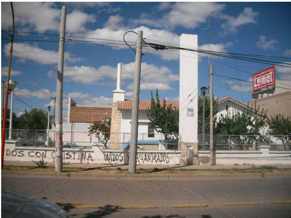
Figura 7.3: Planta de bombeo de líquidos cloacales
