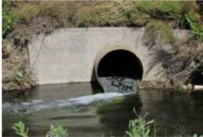
Sitio 6: Descarga Planta de Tratamiento de Líquidos cloacales
