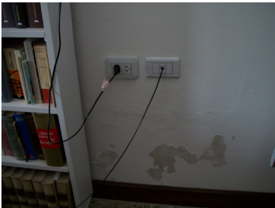
Manchas de humedad
