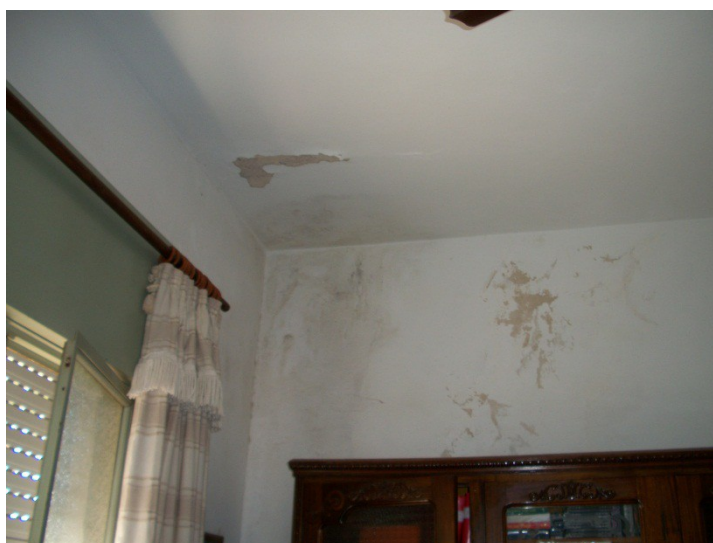
Manchas de humedad
