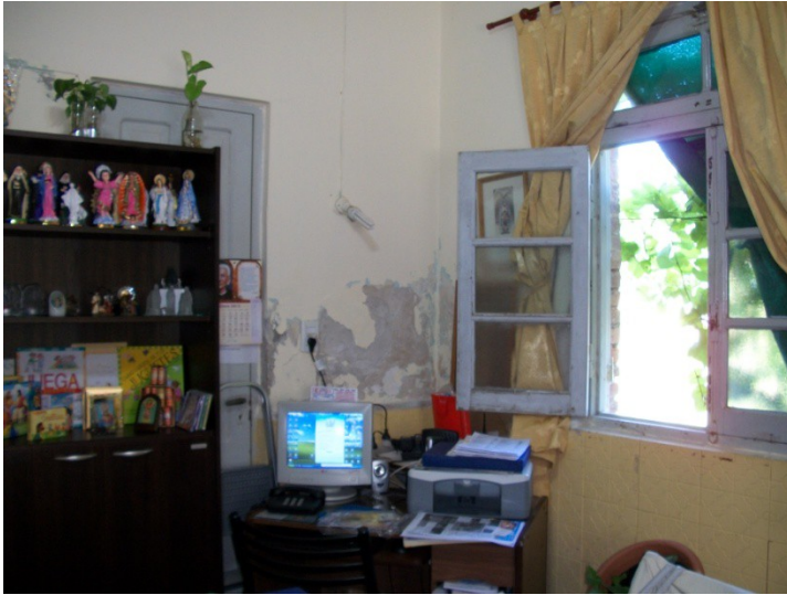
Manchas de humedad y desprendimiento de revoque
