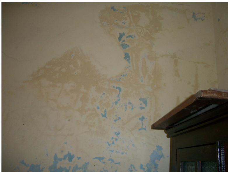
Manchas de humedad
