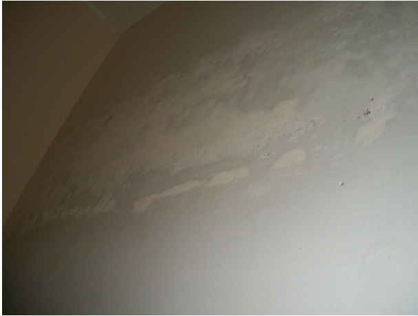
Manchas de humedad
