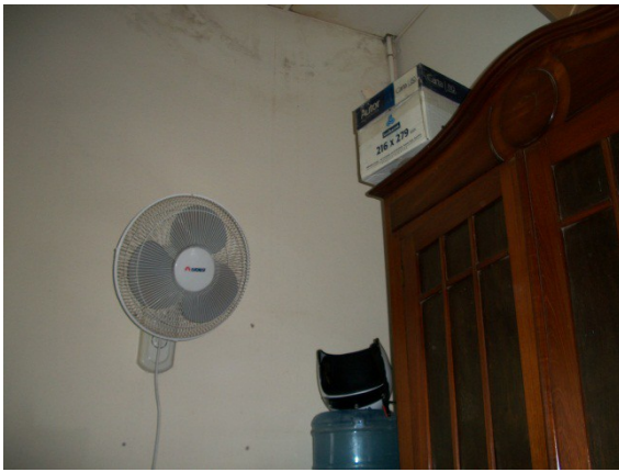
Manchas de humedad
