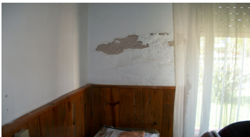
Manchas de humedad y revestimiento de madera
