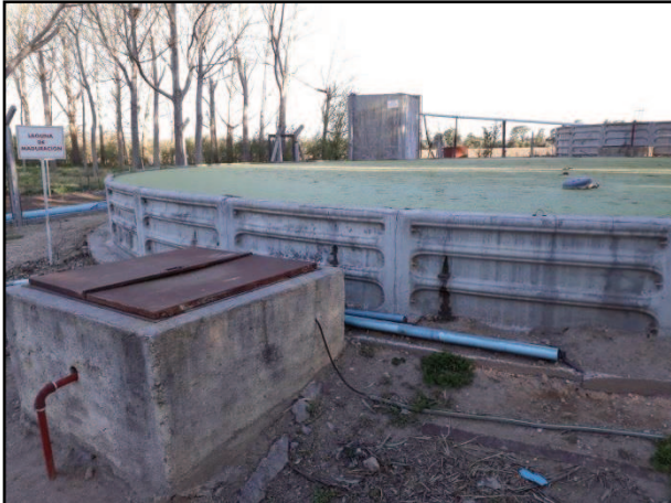
Estación de bombeo de EUT y AC
