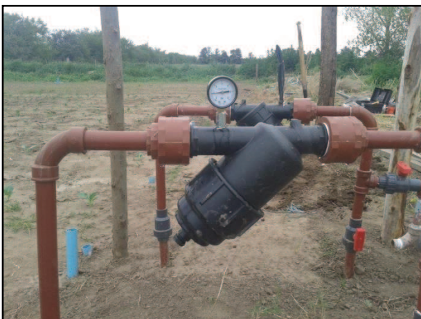
Instalación de los cabezales de riego con EUT y AC
