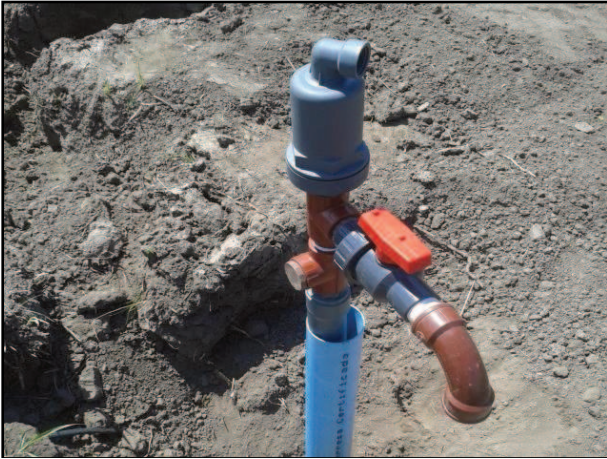
Instalación de la válvula de aire-vacío del sistema
