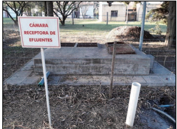
Cámara receptora de efluentes crudos
