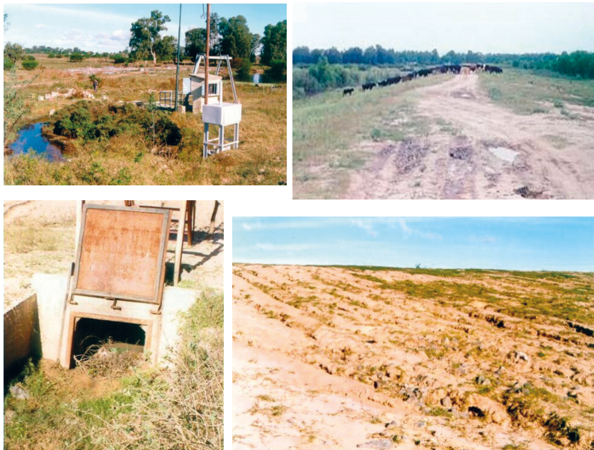
Figura 19.2. Imágenes de deterioros en los terraplenes y estructuras complementarias.
