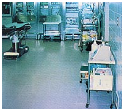
Figura I.3: Azulejos interiores recubiertos con \text{TiO}_2 en un ambiente hospitalario. (Fujishima et al., 1999).
