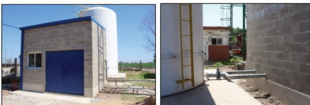
Figura 3.10: Estaciones de bombeo y cisterna del Acueducto en la localidad de Matilde.
