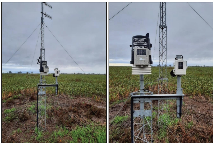
Figura 5.1: Estación meteorológica automática de la SRSCC.
