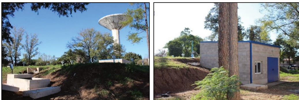
Figura 3.9: Estaciones de bombeo y cisterna del Acueducto en la localidad de San Carlos Centro.
