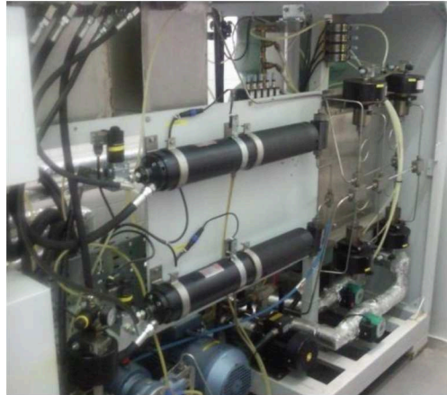
Figura 8. Imagen correspondiente al módulo de servicio del equipo de APH Stansted Fluid Power Ltd. High Pressure Iso-Lab System modelo FPG9400:922.
