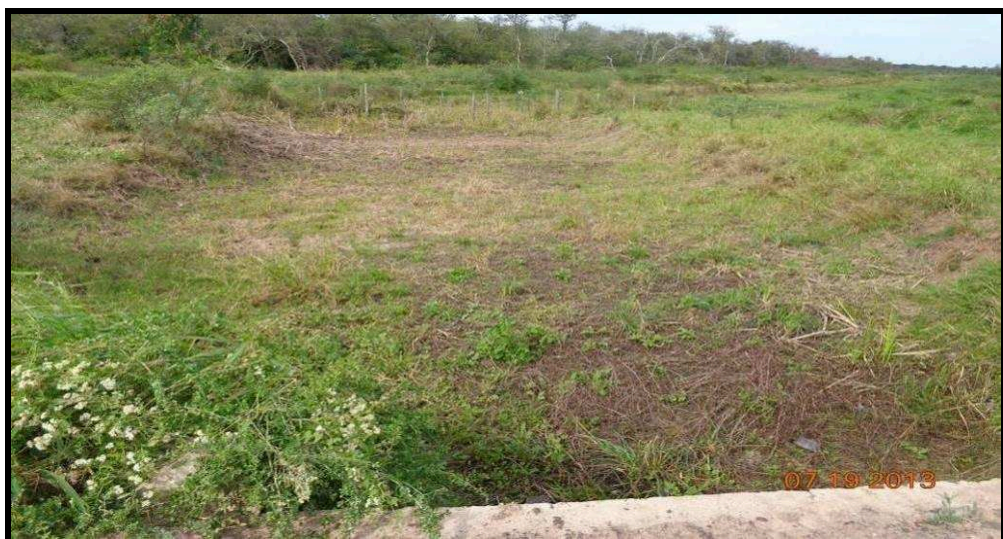
Figura N° 4.31. Alcantarilla y canal (RN N° 95) que alimenta embalse Comandante Fontana
