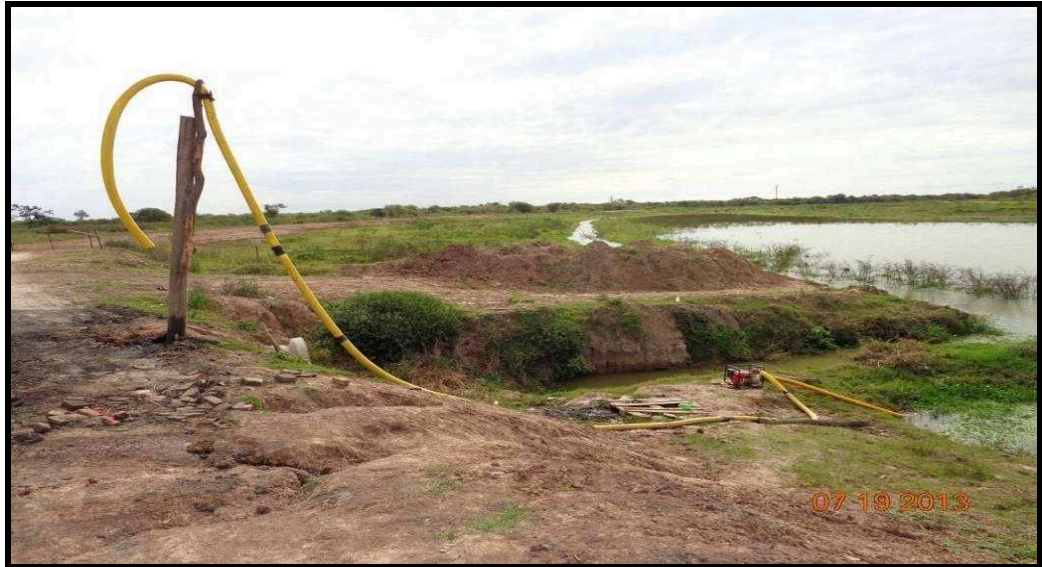
Figura N° 4.34. Estación de bombeo embalse Comandante Fontana
