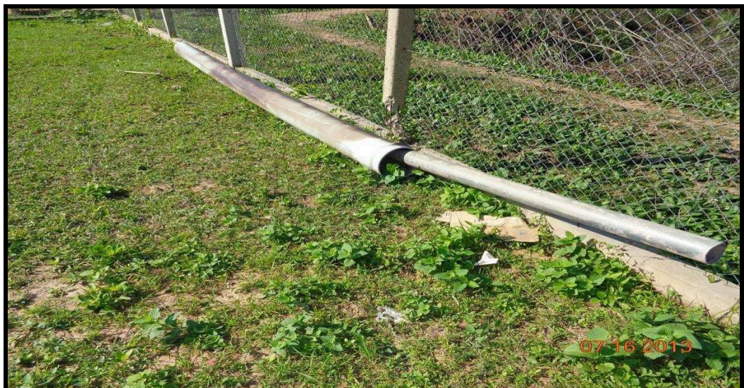
Figura N° 4.21. Caños (conducen el agua desde el riacho Monte Lindo al embalse Pozo del Tigre)
