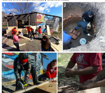
1. Y 2. CONSTRUCCIÓN DE LA AMPLIACIÓN Y DEL POZO ABSORBENTE 3. Y 4. JORNADAS DE CONSTRUCCIÓN COLECTIVA, TAREAS DE CORTE DE MADERAS Y ARMADO DE VIGAS
