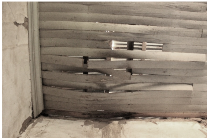
FIGURA 7 | Patología en cielorraso. Fuente: Elaboración propia.
