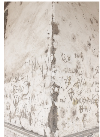
FIGURA 8 | Patologías en revoques. Fuente: Elaboración propia.
