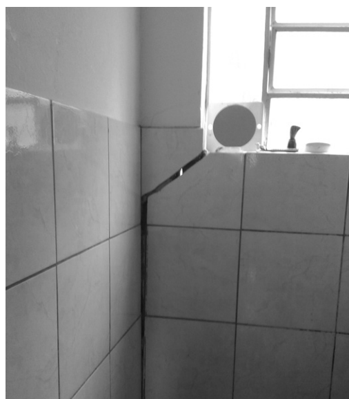
FIGURA 20 | Rachaduras internas (banheiro). Fonte: acervo pessoal (2015).
