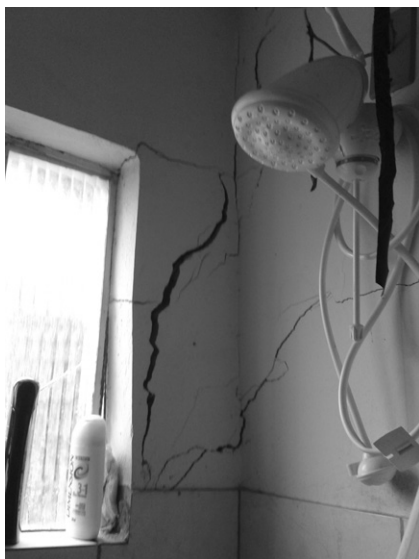
FIGURA 24 | Rachaduras internas (banheiro). Fonte: acervo pessoal (2015).
