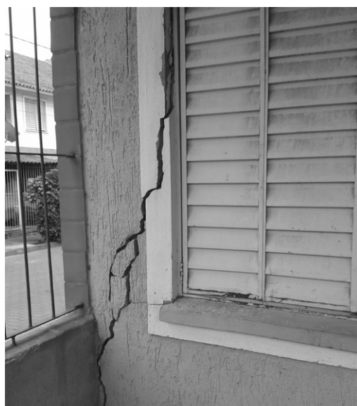
FIGURA 19 | Rachaduras externas (fachada frontal). Fonte: acervo pessoal (2015).
