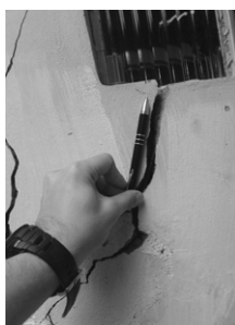
FIGURA 21 | Rachaduras externas (fachada posterior). Fonte: acervo pessoal (2015).
