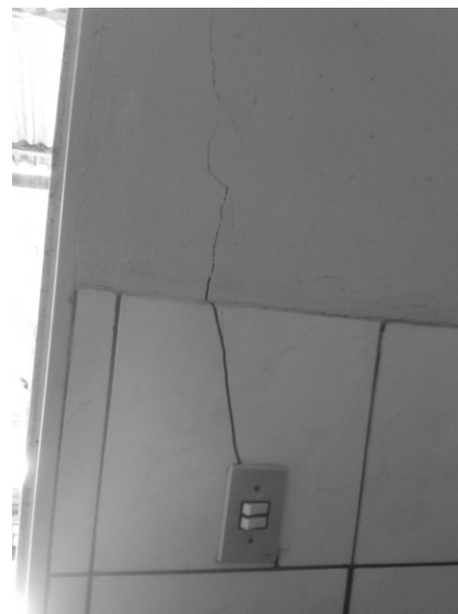
FIGURA 26 | Rachaduras internas (cozinha). Fonte: acervo pessoal (2015).
