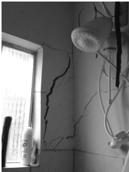
FIGURA 24 | Rachaduras internas (banheiro). Fonte: acervo pessoal (2015).
