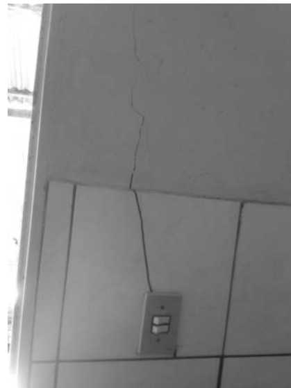
FIGURA 26 | Rachaduras internas (cozinha). Fonte: acervo pessoal (2015).
