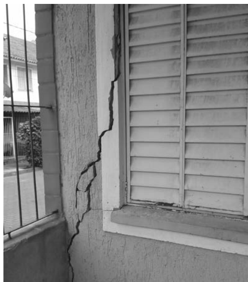
FIGURA 19 | Rachaduras externas (fachada frontal). Fonte: acervo pessoal (2015).
