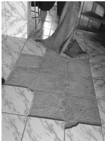
FIGURA 25 | Rachaduras internas (sala). Fonte: acervo pessoal (2015).
