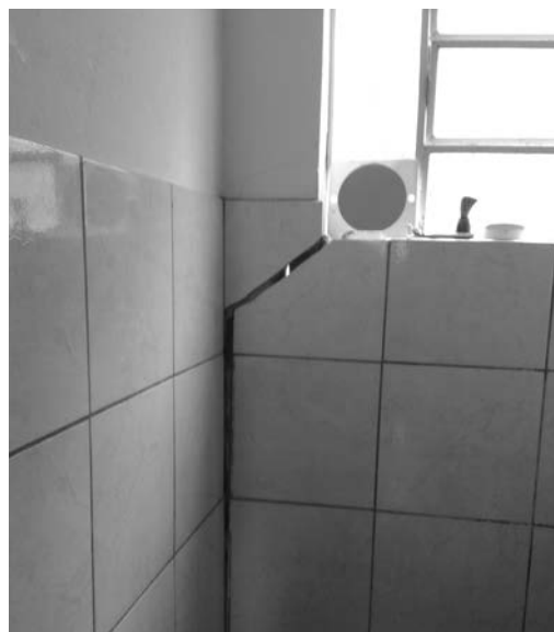
FIGURA 20 | Rachaduras internas (banheiro). Fonte: acervo pessoal (2015).
