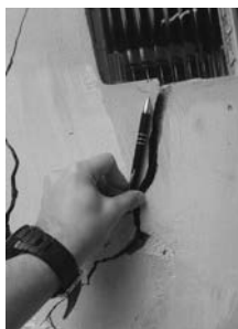
FIGURA 21 | Rachaduras externas (fachada posterior). Fonte: acervo pessoal (2015).
