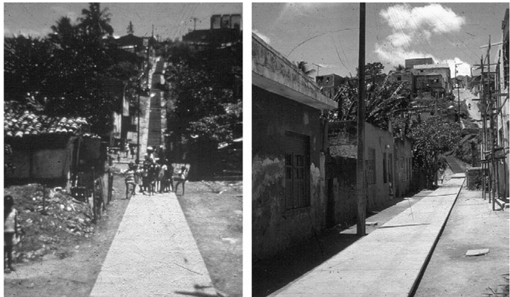
FIGURA 2 | Micro-drenagem executada em argamassa armada e implantada entre as casas de bairros populares na Bacia do Camurujipe, em Salvador, 1980. Fonte: Instituto João Figueiras Lima.
