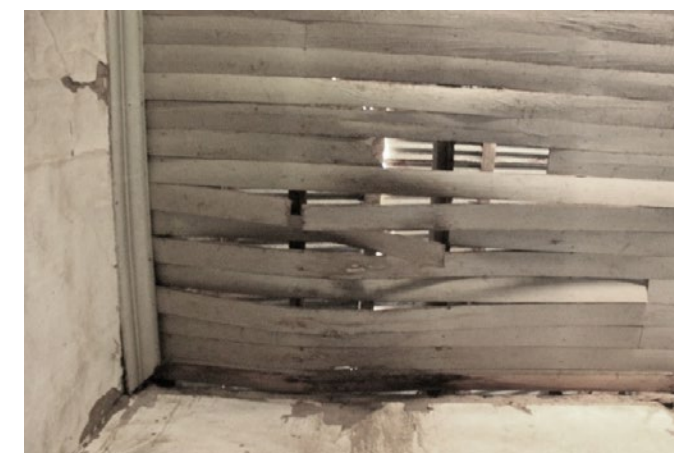
FIGURA 7 | Patología en cielorraso. Fuente: Elaboración propia.
