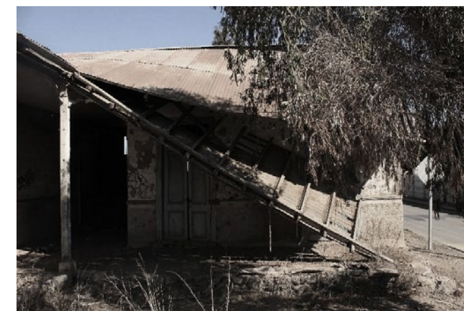
FIGURA 9 | Desplome lateral de alero en techumbre. Fuente: archivo propio.
