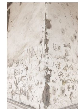
FIGURA 8 | Patologías en revoques. Fuente: Elaboración propia.
