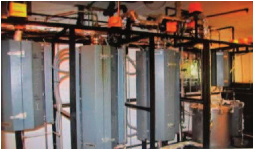
Figura 1.6. Planta Piloto de producción de H 2 para alimentar una celda PEM de la UBA.
