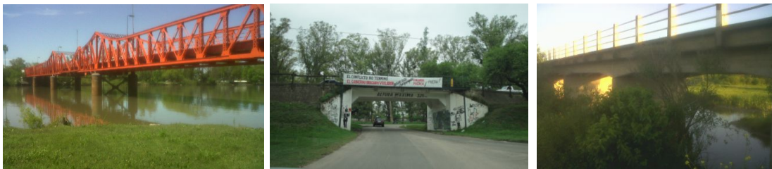
Figura 4.55. Vista del puente metálico, el cruce bajo nivel y del puente aliviador
