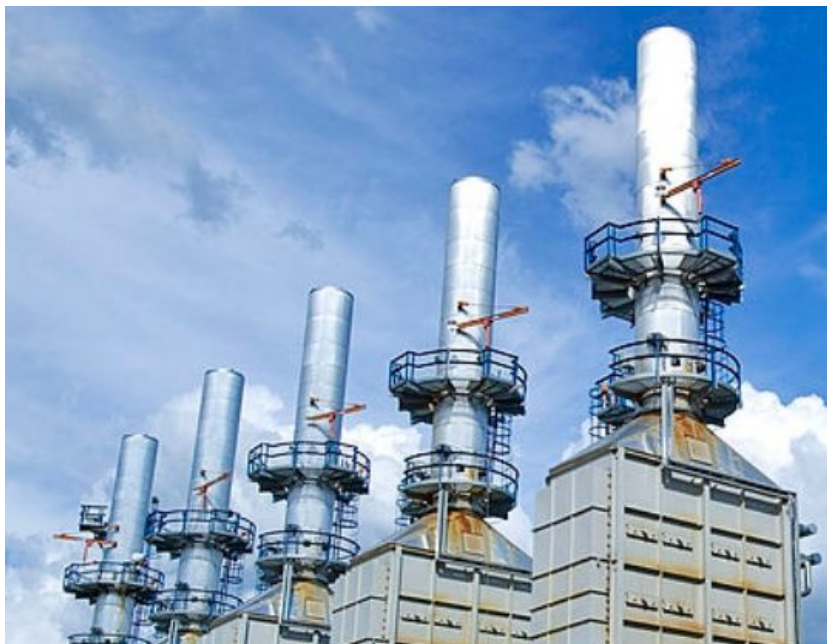
Figura 1.2: Estación generadora de vapor.
