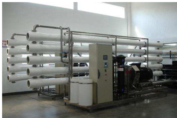
Figura 4.32. Instalaciones correspondientes a una Planta de Osmosis Inversa
