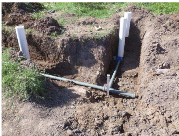
Figura 4.17. Red de agua potable y sus llaves de paso
