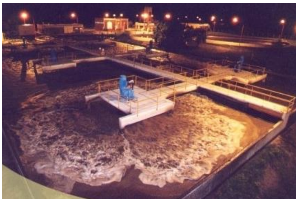
Figura Nº 46: Reactor Biológico de la planta de tratamientos de efluentes. Consorcio para la preservación de la ecología S.A. Esperanza. Santa Fe.
