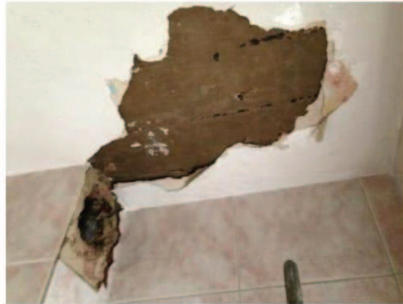
DESPRENDIMIENTO DEL CIELORRASO
