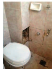
FOTO 6 -Retiro de cerámica para descubrir humedad dentro del revoque, verificar que el agua se deslizaba a través del montante.
