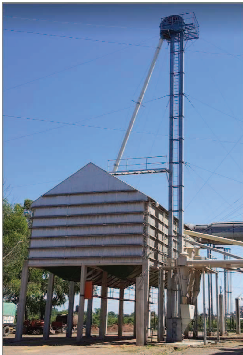
Figura 5. Silo de chapa aéreo Fuente: Propia
