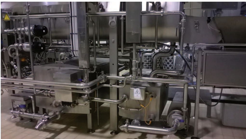
Figura 2.16 Vista posterior de la hiladora para Mozzarella de alta humedad. Sistema de recirculación de agua de hilado y depósito de salmuera con dosificador (izquierda).
