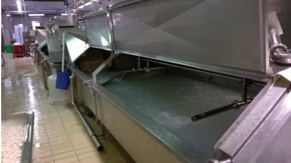
Figura 2.14 Canal de enfriamiento con dos secciones.
