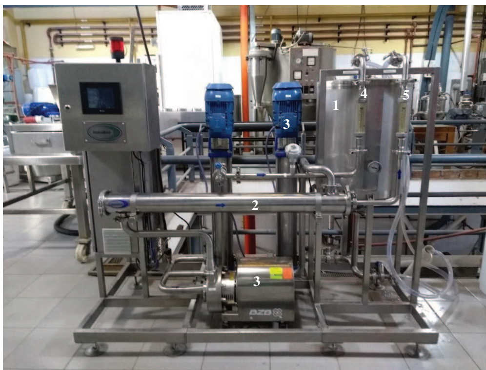
Figura 28. Equipo de filtración por membranas a escala piloto: (1) tanque de alimentación; (2) membrana de ultrafiltración; (3) bomba; (4) concentrado; (5) permeado.
