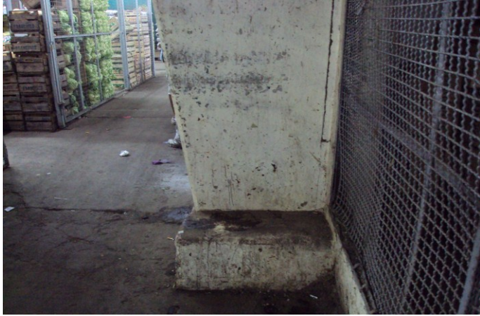
Vista del estado de paredes internas de la nave en Mercado de Productores de Rosario
